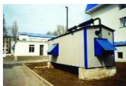
Контейнер NeuHaus с установленным ДГУ
