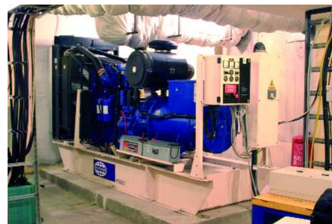
Дизельный электрогенератор FG Wilson, установленный в цокольном этаже здания
