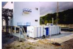
Контейнер NeuHaus с ДГУ 1 МВт
