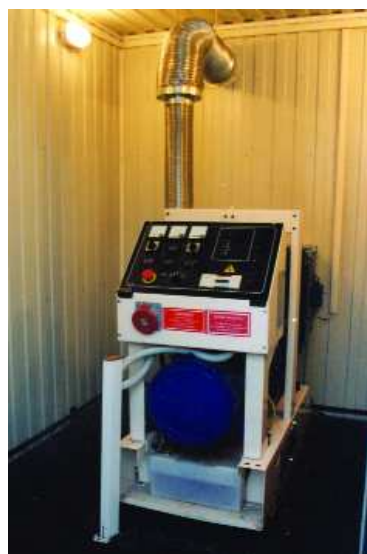
ДГУ FG Wilson в контейнере производства НойХаус Групп
