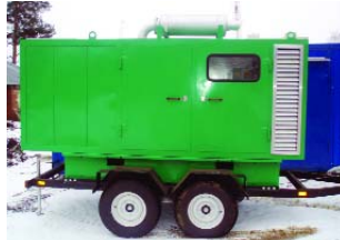
ДГУ в шумозащитном кожухе производства НойХаус, установленный на шасси-прицепе. Изготовлено производственным отделом компании.
