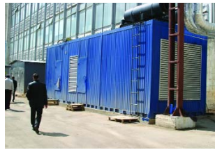
Автоматизированный контейнер для ДГУ Cummins C2250 D5. Изготовлено производственным отделом компании для реализации проекта гарантированного энергоснабжения дата-центра Stack M1.
