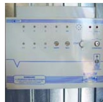
Щит пожарно-охранной сигнализации
