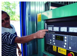
ДГУ Cummins в автоматизированном модуль-контейнере производства Группы Компаний НойХаус. Испытательный запуск установки.
