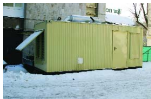
Автоматизированный контейнер для ДГУ Cummins C550 D5. Изготовлено производственным отделом компании для реализации проекта гарантированного энергоснабжения телекомпании ВГТРК.
